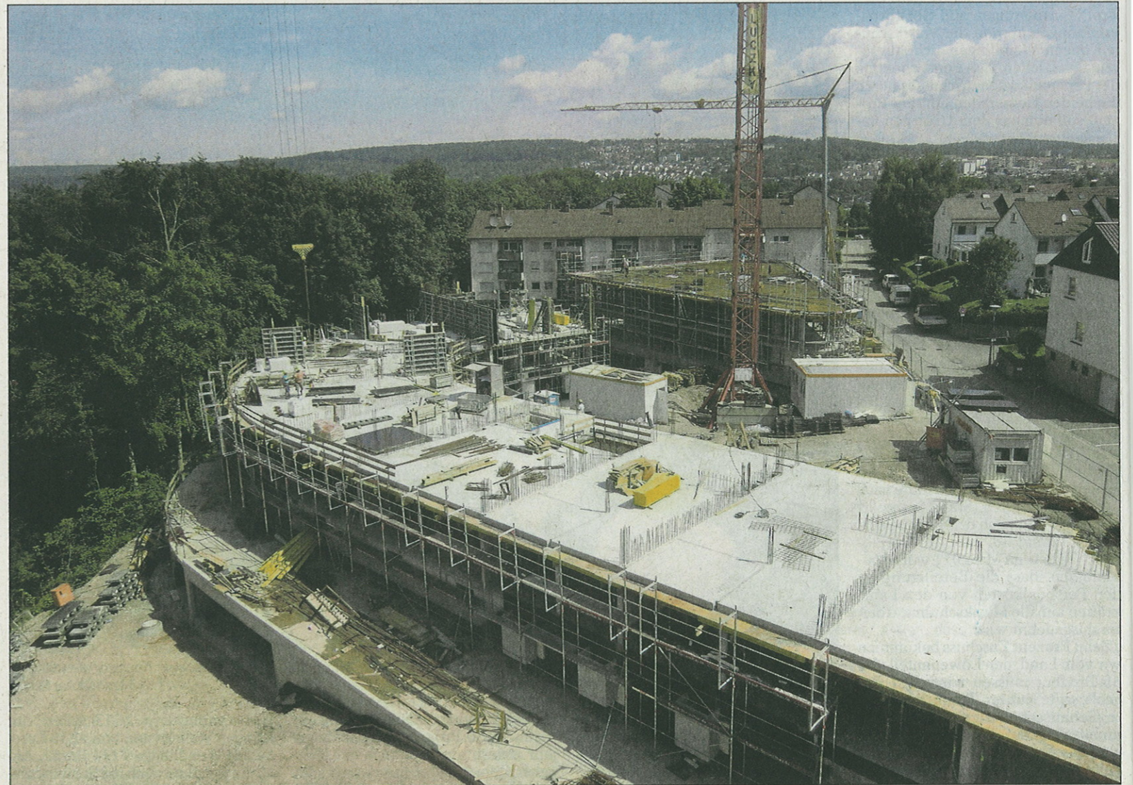
Im Mörikeweg baut die Wohnungsbaugenossenschaft Wernau den Ersatz für drei der historischen Bauten, die abgerissen wurden. In einem ersten Schritt entstehen 42 Wohnungen in einem bogenförmigen Bau. Den Abschluss bildet ein fünfgeschossiger Turm (hinten). Foto: Wohnungsbaugenossenschaft Wernau
